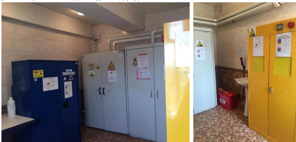
Зураг 4. Химийн бодисын агуулахын тохижилт /шкаф EAGLE bv, АНУ/
