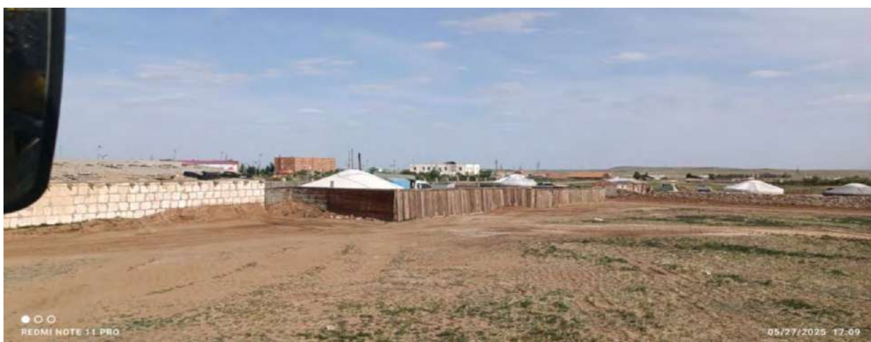
Зураг №11 05-р сарын 27-28-ны өдөр Сумын төвийн элс шороо түрэх ажлын дараа
