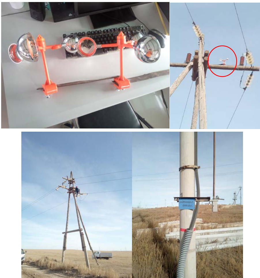
Зураг 22. Шувуу үргээгч суурьлуулсан өндөр хүчдэл
