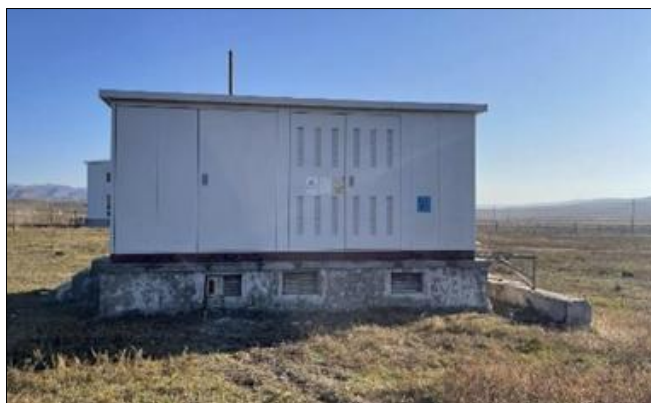
Зураг 8. Цахилгааны дэд станц
