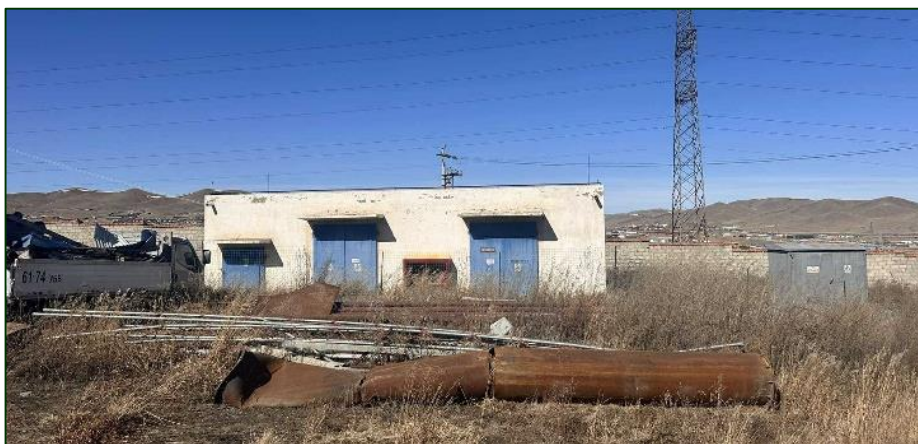
Зураг 10. Цахилгааны дэд станц (КТПН) болон нөөц эх үүсвэр
