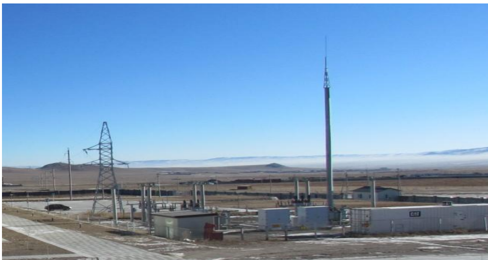
Зураг 3 Цахилгааны 35/0,4 кВ-ын дэд станц
