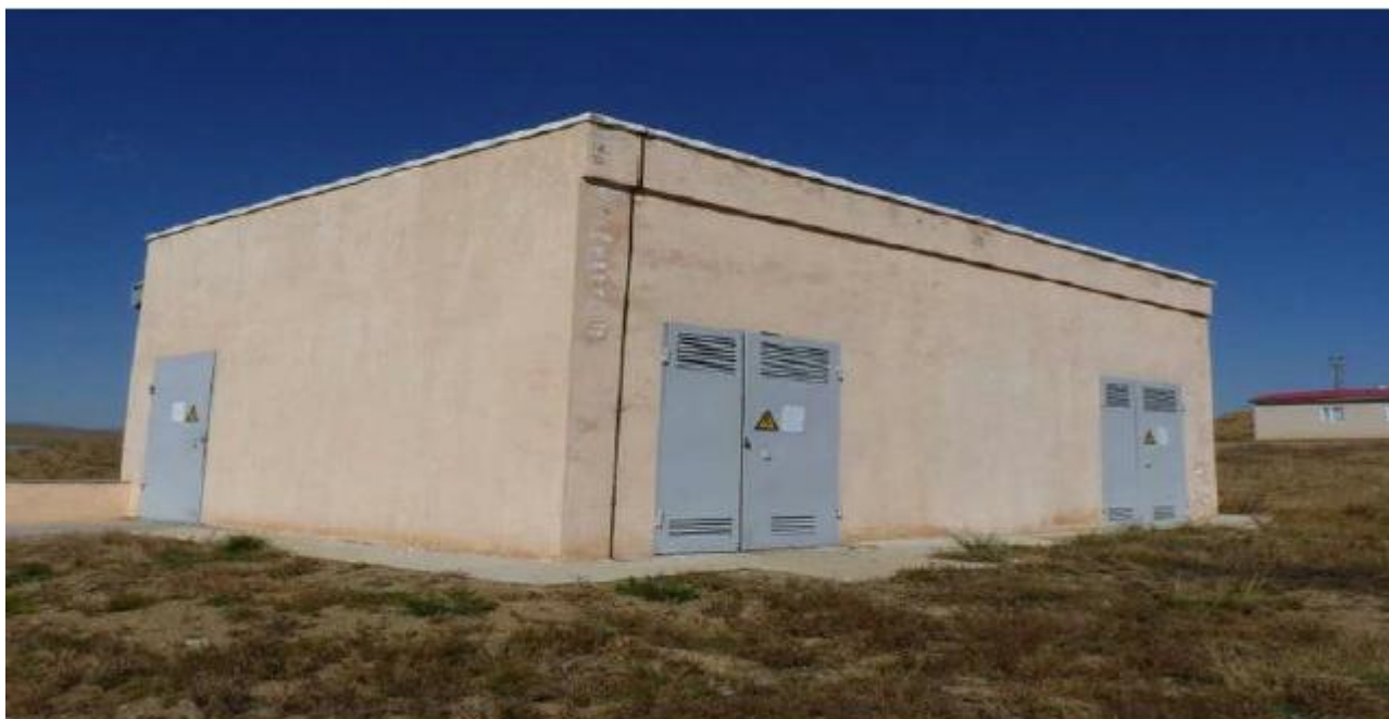
Төслийн цахилгаан үүсгүүр буюу 380В-ын трансформатор
