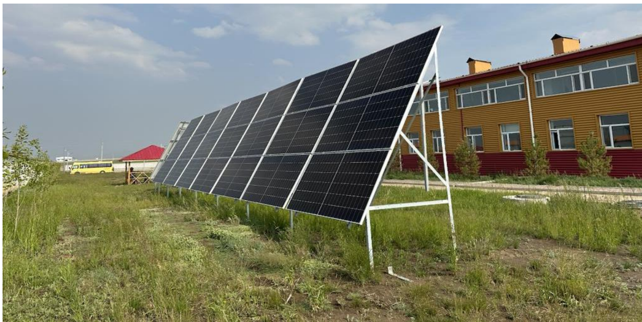
Зураг 6 Үйлдвэрийн байрны урд хэсэг нарны цахилгаан үүсгүүр
