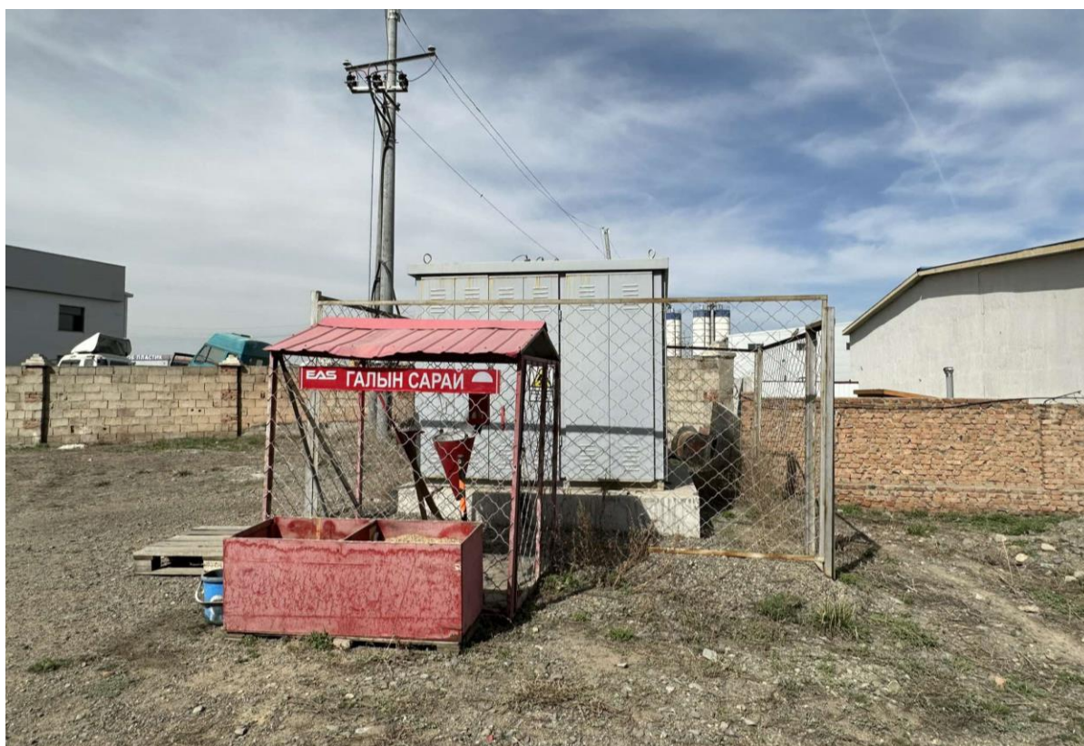
Зураг 7 Цахилгааны трансформатор, галын сараа
