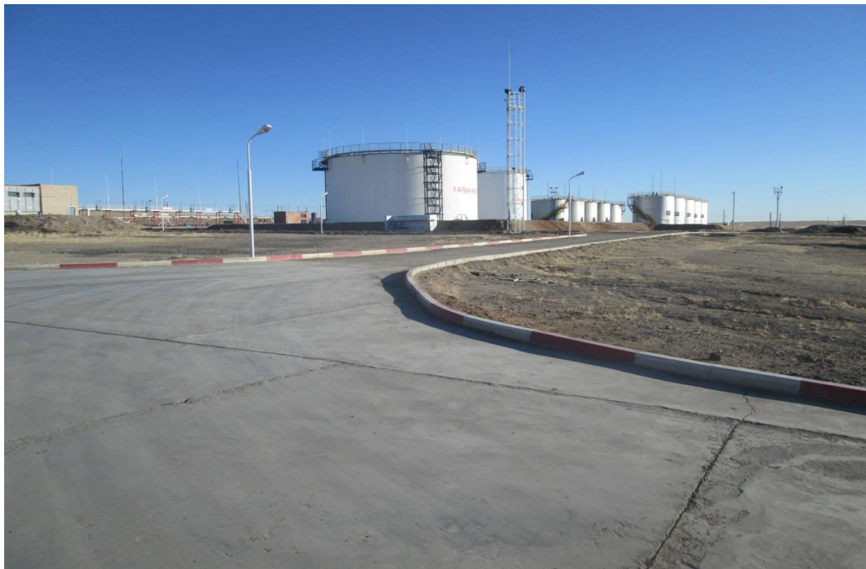
/Зураг-2 Газрын тосны бүтээгдэхүүний агуулах дээр босоо цилиндр ган савнууд суурилуулсан байдал сав паркын далан/
