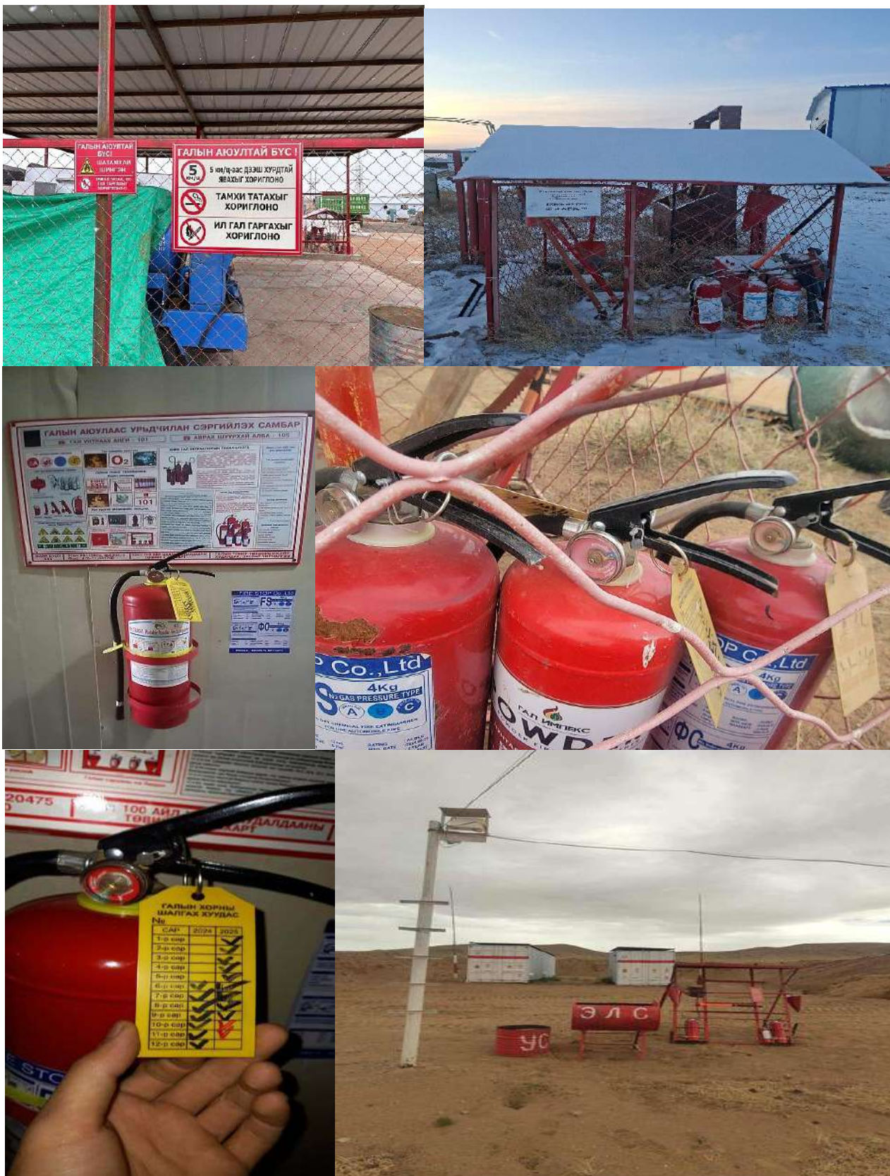
Зураг 57. Галы хор, аюулгүйн самбар байршуулсан байдал
