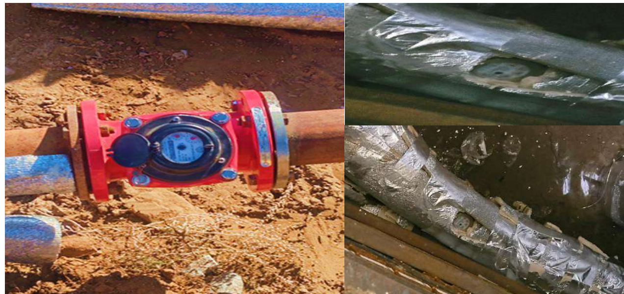
Зураг 11. Худгийн гадна байршуулсан тоолуурны зураг
