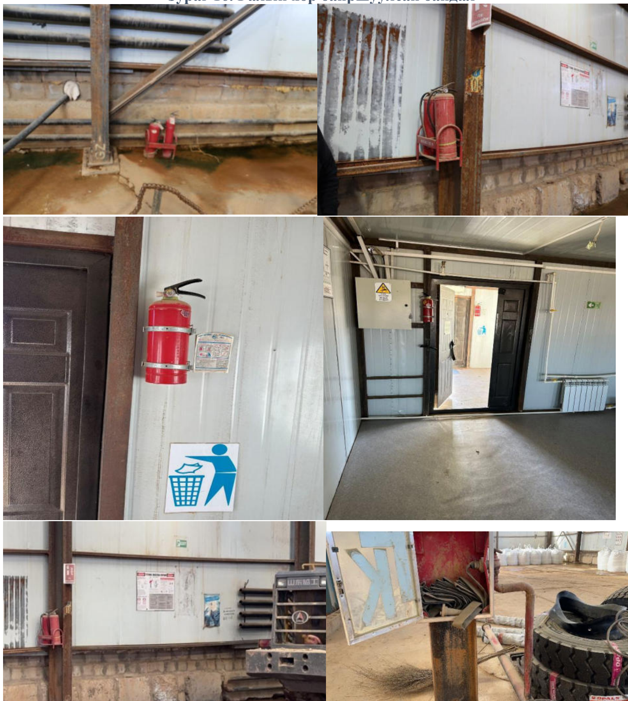
Зураг 16. Галын хор байршуулсан байдал
