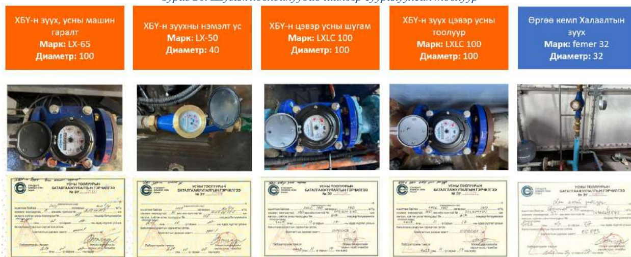
Зураг 26. Шугам хоолойнуудад шинээр суурилуулсан тоолуур
