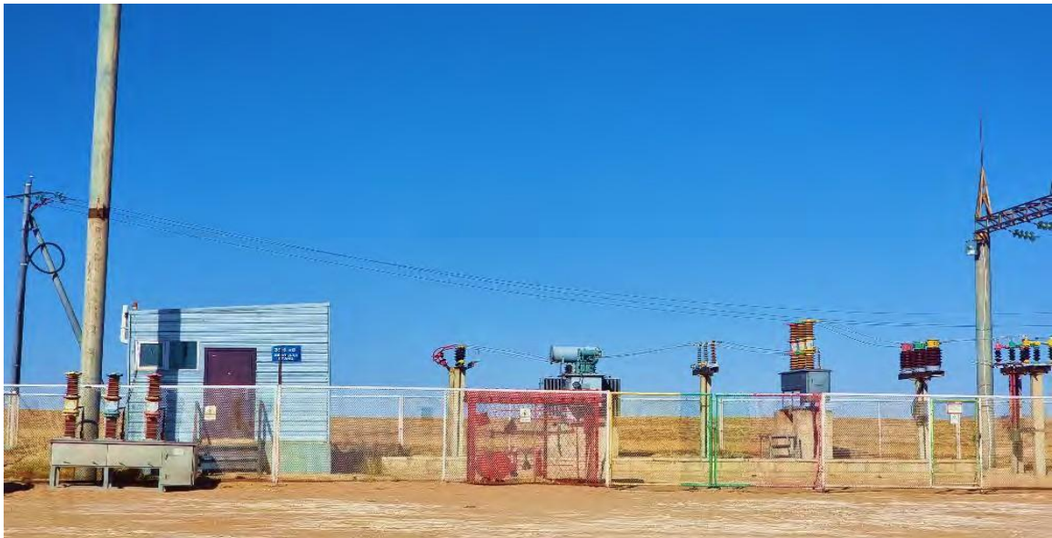
Зураг 1: Хөөтийн уурхайн цахилгаан дамжуулах 35кВ дэд станц
