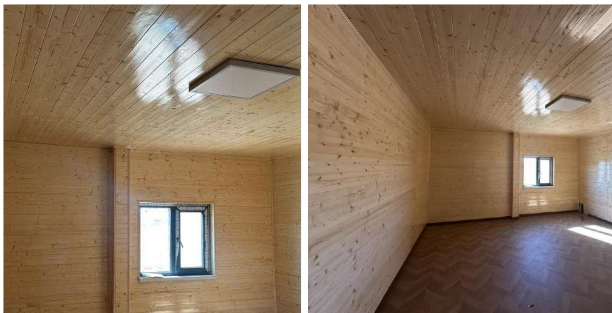
Зураг 25. Уурхайн хотхоны барилгын дотор өрөө тасалгаа үүдний хэсгүүдэд хөдөлгөөн мэдрэгчтэй гэрэл суурилуулсан байдал
