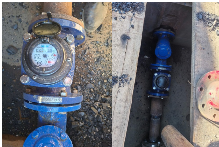
Зураг 7. Тоолуур суурьлуулалт
