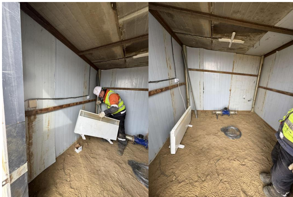
Зураг 20. Тоолуур суурилуулсны дараа хөлдөхөөс сэргийлж байгууламж бэлдэн, тог цахилгааныг шийдсэн, тен байрлуулсан байдал.
