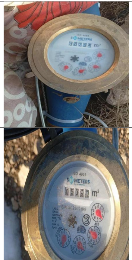
Зураг 0-5. Суурилуулсан тоолууруудын харагдах байдал
