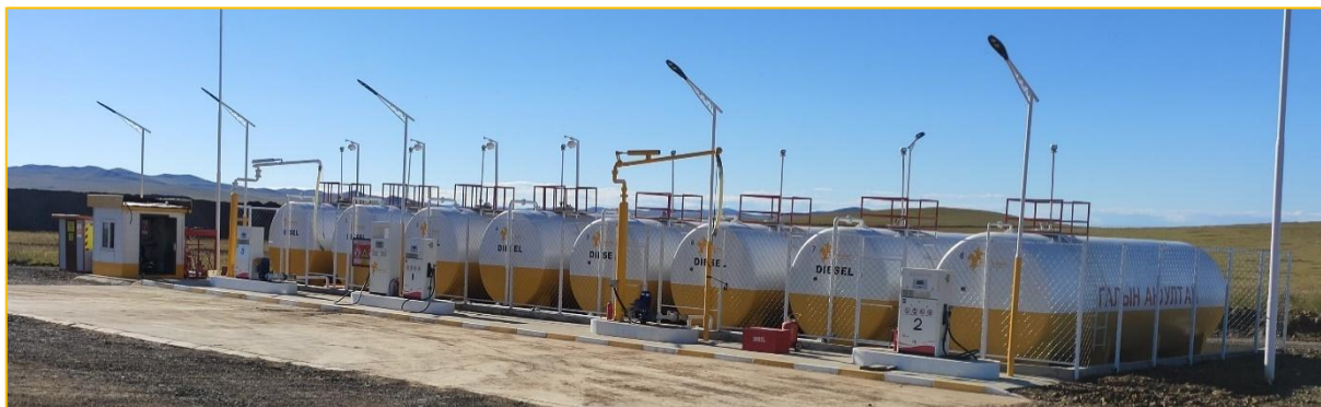
Зураг 6. Дизель түлш түр хадгалах, түгээх станц
