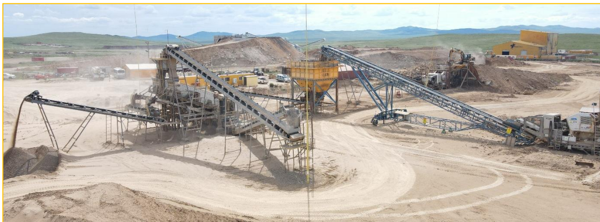
Зураг 9. Хүдэр бутлах тоног төхөөрөмж
