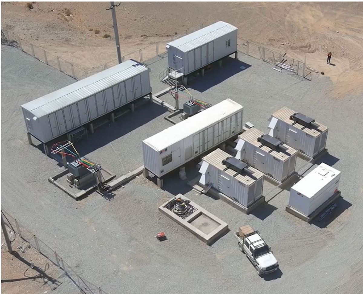
Зураг 3. 0.4/10 кВ 2500кВА дизель станц
