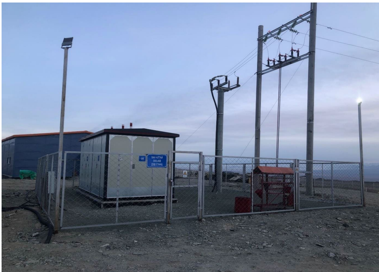
Зураг 2. 35/0.4 кВ 800кВА дэд станц
