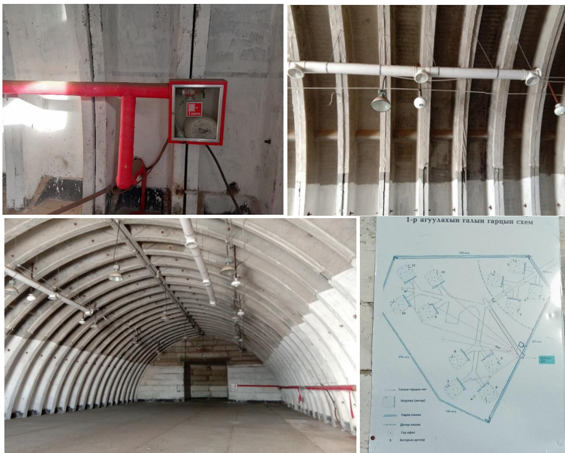
Зураг 6. Агуулахын доторх галын гидрант болон агааржуулалт, гэрэлтүүлгийн холболтууд
