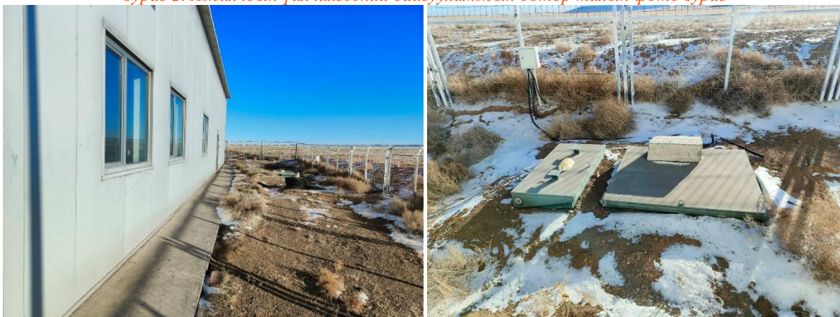
Зураг 6. Ажилчдад үйлчилэх байгууламжийн бохирын цооног
