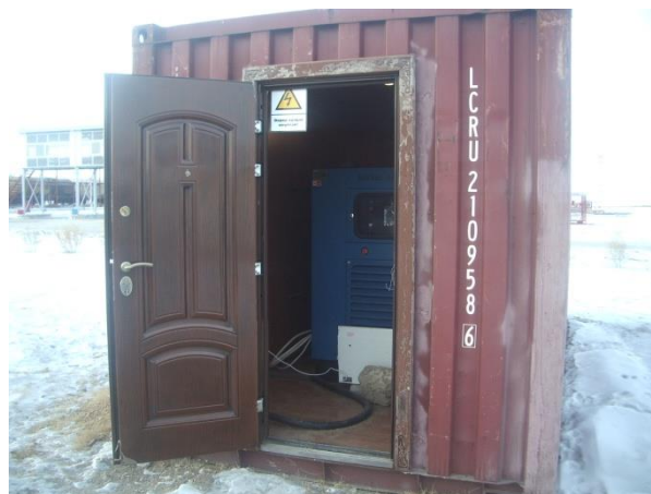
Зураг-6 Аваарын генератор
