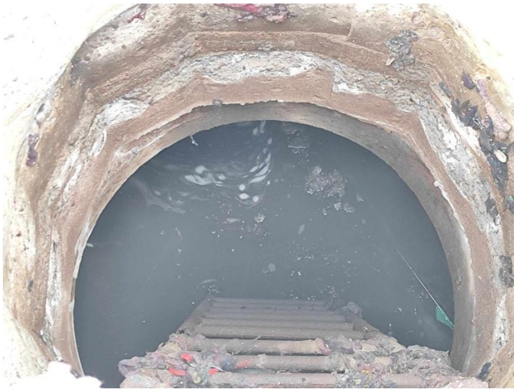
Будах үйлдвэрийн гадна газар доор байрлах технологийн устай 10тн худгийн байдал
