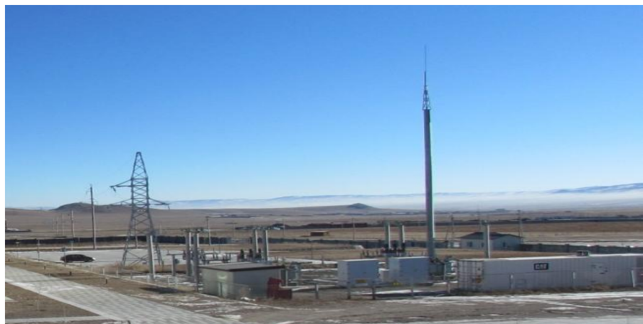
Зураг 3: Цахилгааны 35/0,4 кВ-ын дэд станц
