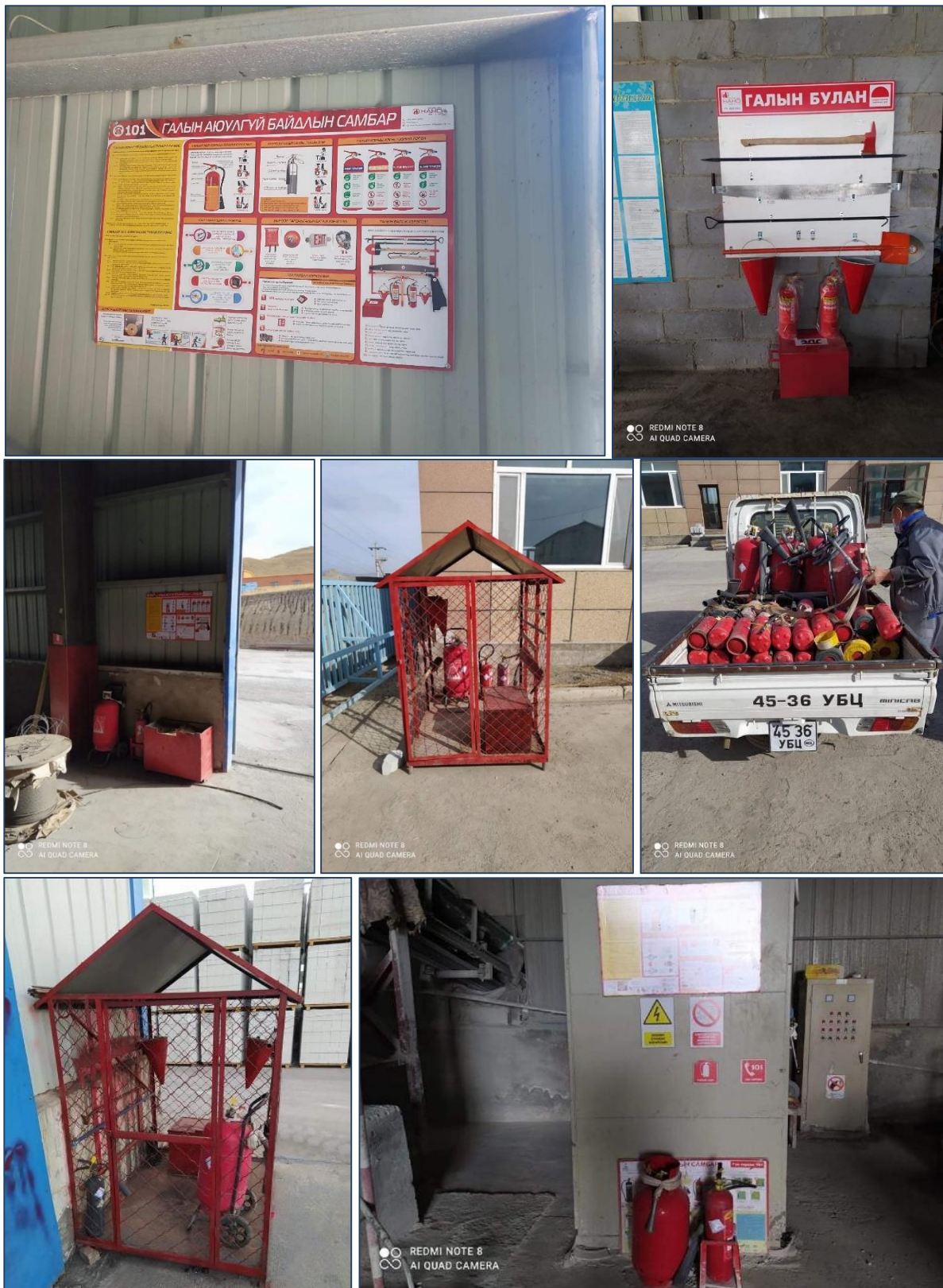
Зураг 22. Гал унтраах зөөврийн болон суурин тоног төхөөрөмж, багаж хэрэгслүүдийг бэлтгэсэн байдал
