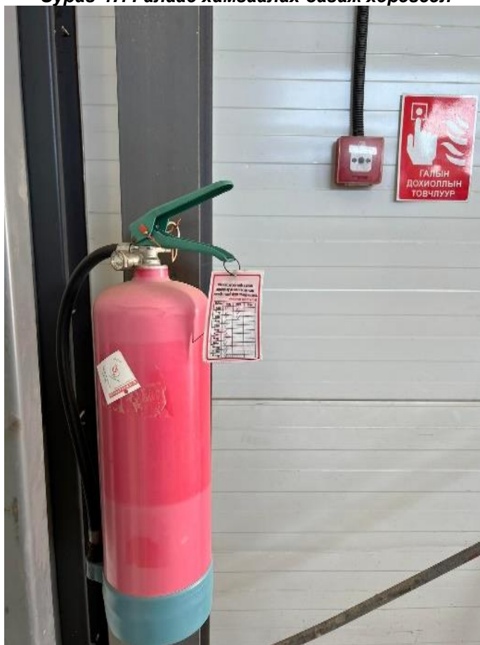
Зураг 48. Үйлдвэр, агуулахад галын хорыг байршуулсан байдал
