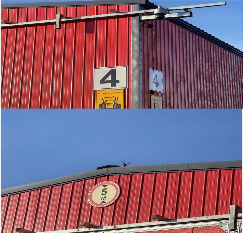
Зураг 11. Газардуулга байршуулсан байдал
