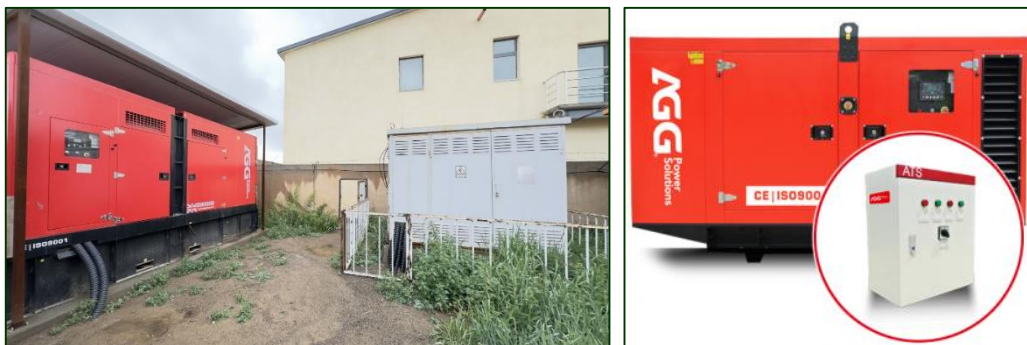
Зураг 4. Цахилгааны дэд станц (КТПН) болон нөөц эх үүсвэр (дизель генератор С650D5)
