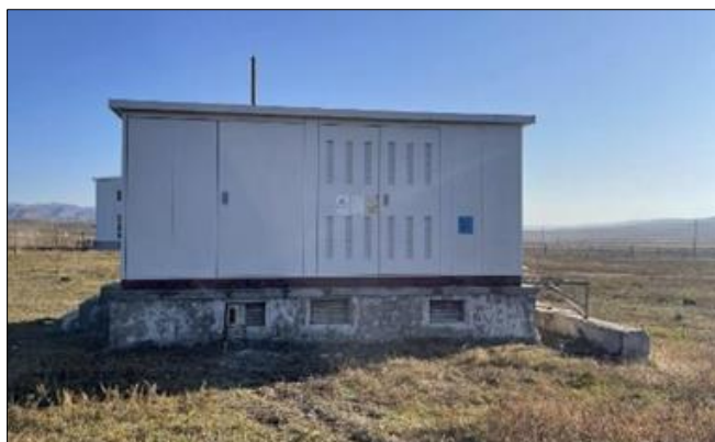
Зураг 8. Цахилгааны дэд станц
