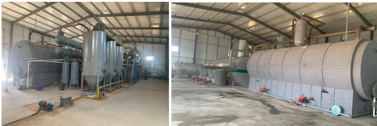
Зураг 4. Үйлдвэрийн үндсэн тоног төхөөрөмж, тэдгээрийн угсралтын байдал
