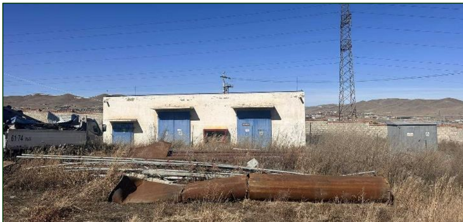
Зураг 9. Цахилгааны дэд станц (КТПН) болон нөөц эх үүсвэр
