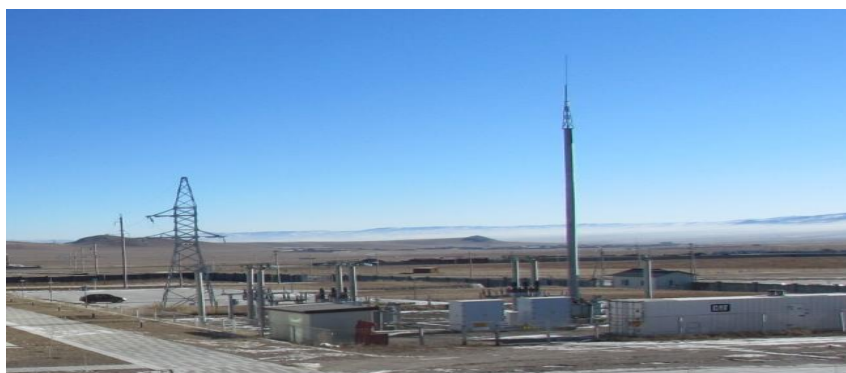
Зураг 3 Цахилгааны 35/0,4 кВ-ын дэд станц
