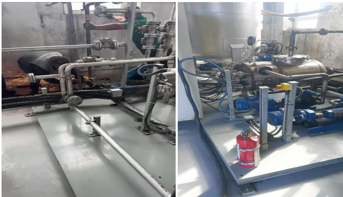
Зураг 16. Үйлдвэрийн тоног төхөөрөмжний засвар үйлчилгээ
