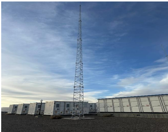
Зураг 7. Станцын аянга зайлуулагч
