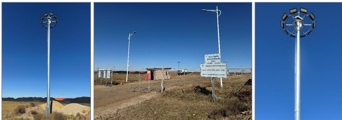
Зураг 28. Төслийн талбайд байршуулсан гэрэлтүүлэг
