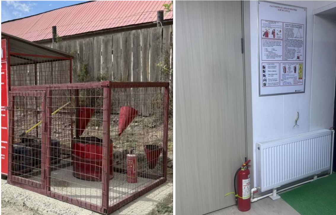
Зураг 10. Төслийн талбайд байрлуулсан гал унтраах багаж хэрэгсэл
