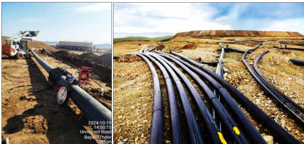
Зураг 33. Үйлдвэрийн шугам хоолой
