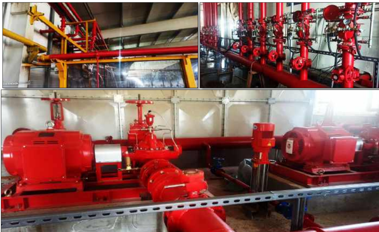
Зураг 83. Үйлдвэр доторх галын автомат систем
