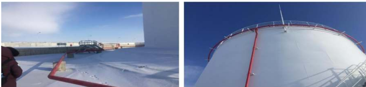
Зураг 1-14. Галын усан сан, сав хөргөх, усан хөшиг үүсгэх тоног төхөөрөмжийг байрлуулсан байдал
