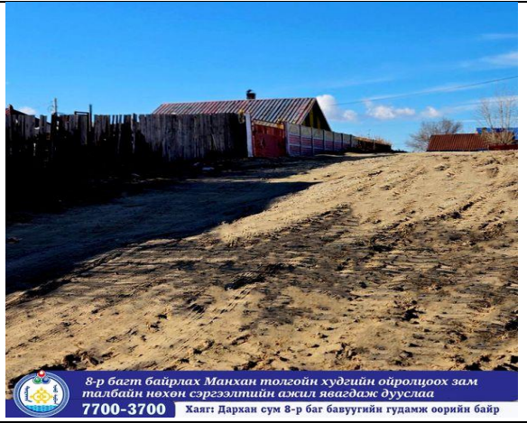
8-р багт байрлах Манхан толгойн худгийн ойролцоох зам талбайн нөхөн сэргээлтийн ажил явагдаж дууслаа 7700-3700 Хаяг: Дархан сум 8-р баг бавуугийн гудамж оорийн байр
