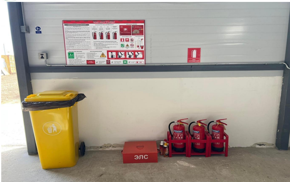
Зураг 7. Агуулахын дотор байрлах галын хэрэгсэл
