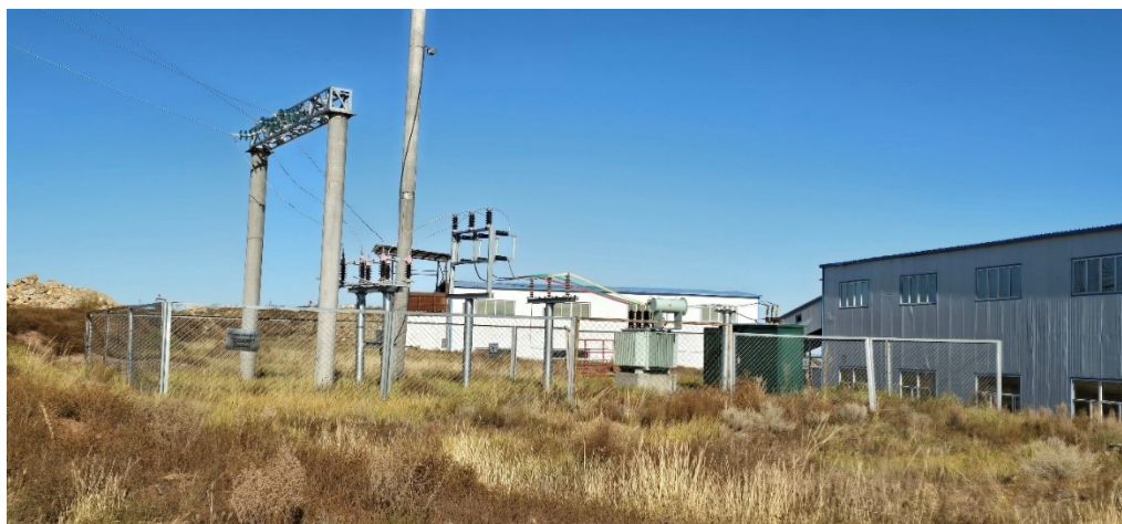
Зураг 7. Баяжуулах үйлдвэрийн дэд станц
