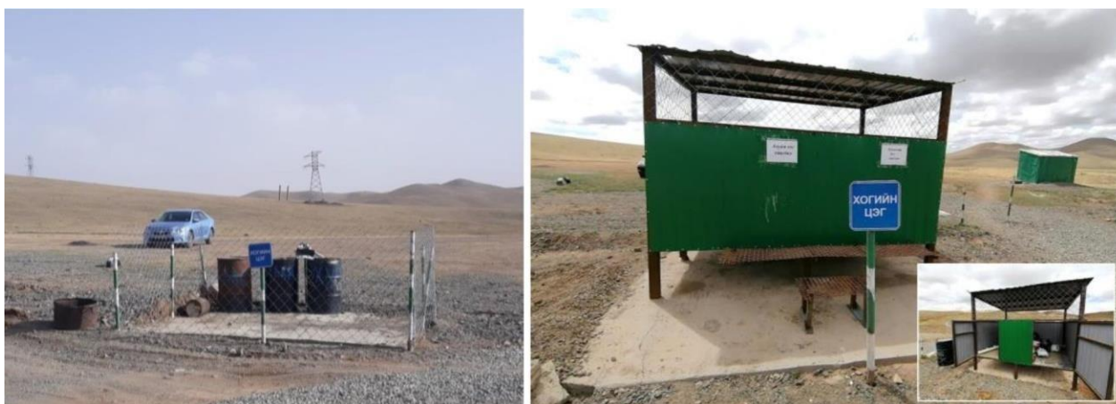
Зураг 27 . Энгийн хог хаягдал түр хадгалах бункер
