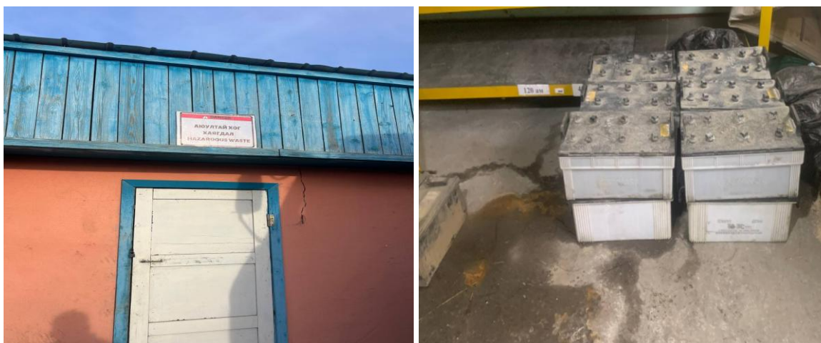
Зураг № 8.10 Хаягдал аккумулятор түр хадгалах цэг
