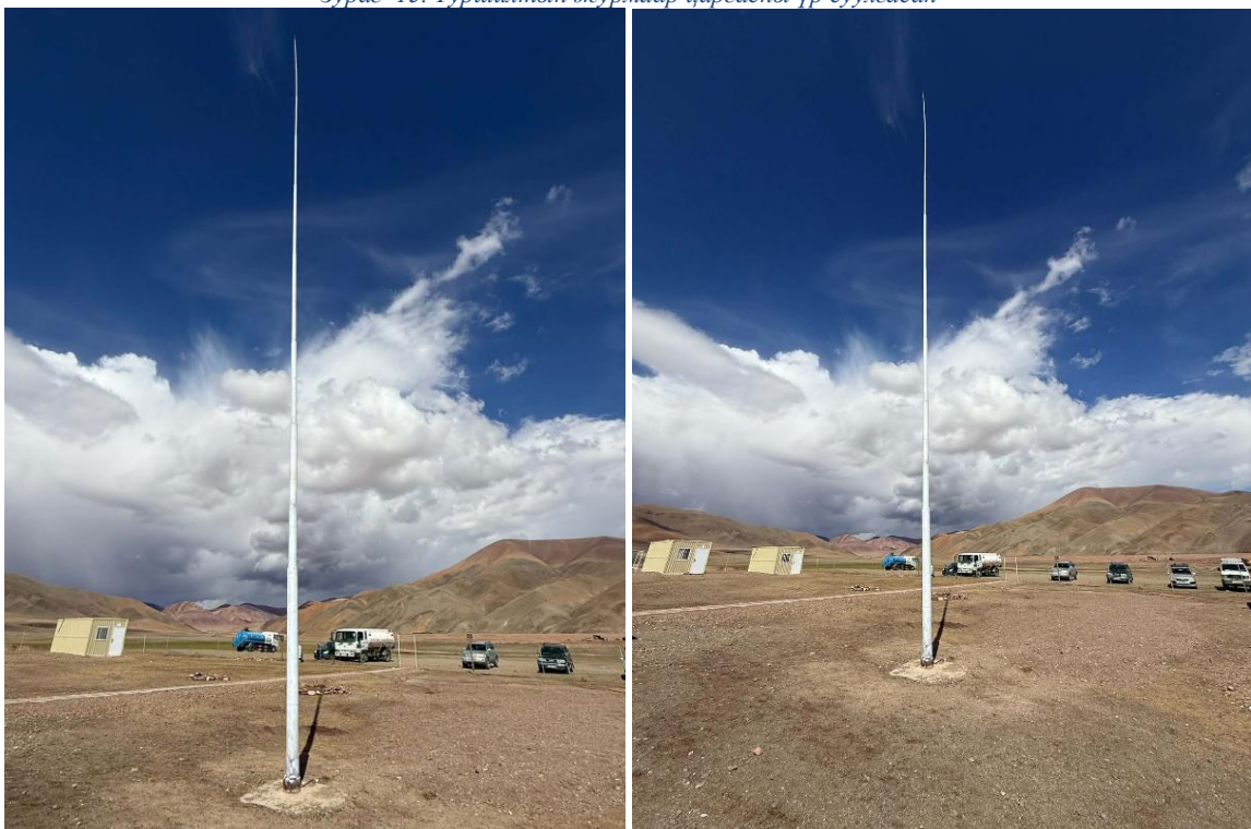
Зураг 16. Шинээр байршуулсан аянга зайлуулагч
