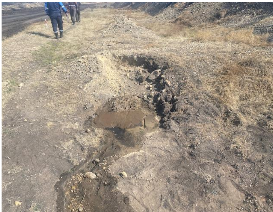
Ус дамжуулах шугам цоорсон байдал
