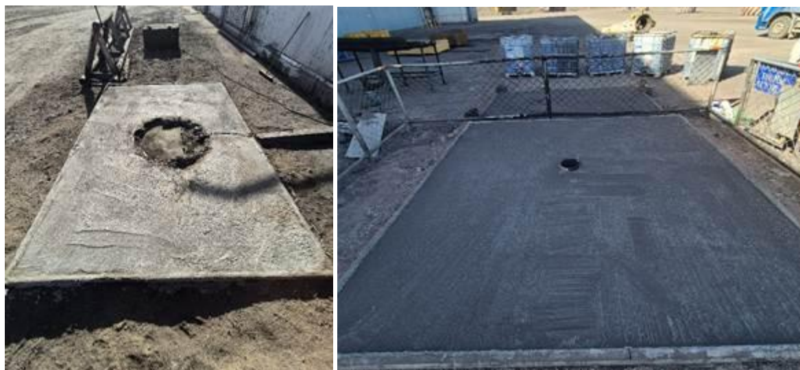
Зураг 10.7.3. Уурхайн засварын төвийн хаягдал тосны 2 нөөцлүүрийн дээд талын хөрсийг бетондсон байга байдал
