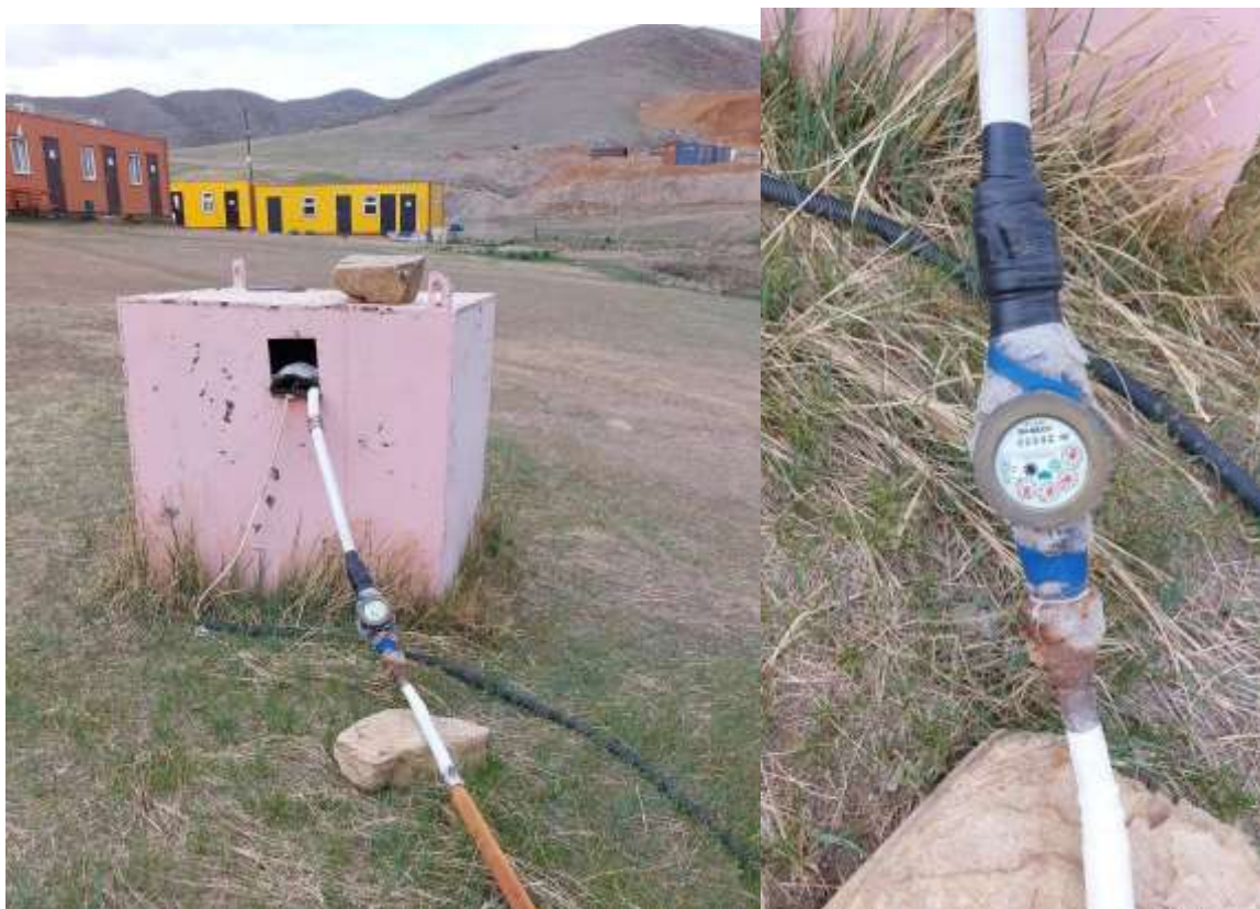
Зураг 13 Уст цэгт байрлуулсан тоолуур
