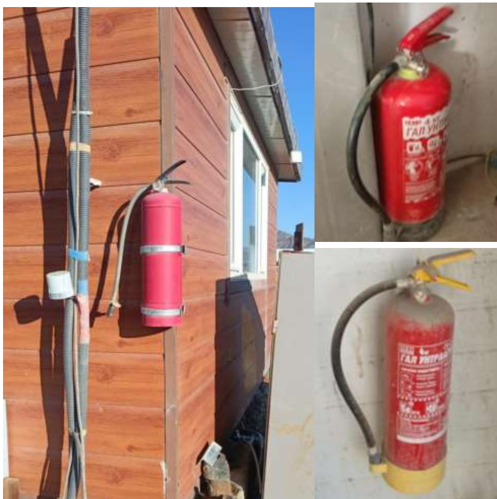
Зураг 34 Үйлдвэрийн талбай болон ажлын талбайнуудад галын хор байршуулсан
