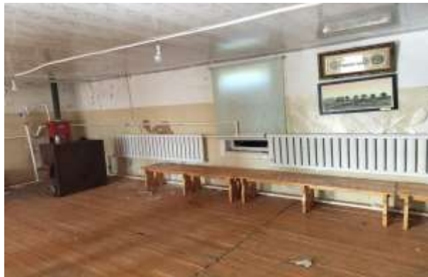
Зураг 34. Нард багт халаалт шийдэж өгсөн байдал
